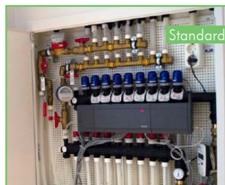
Koblingsskap til gulvvarme
